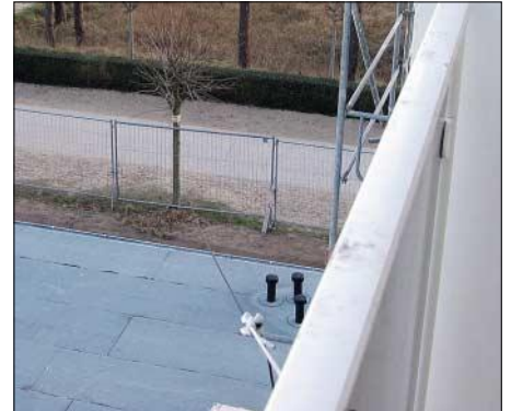
Befestigungspunkt der Antenne zum Strand
